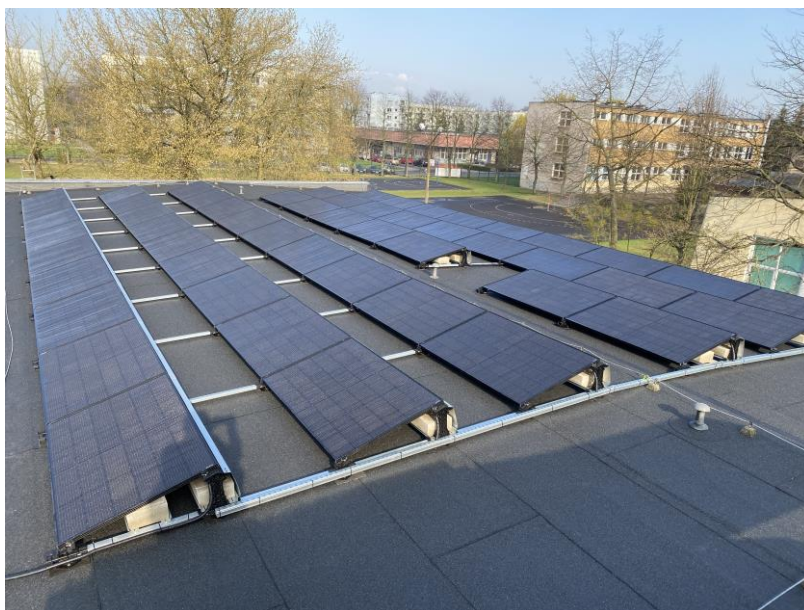
Panele fotowoltaiczne na dachu budynku Zespołu Szkół nr 1 w Nowym Tomysłu.
